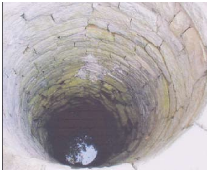
Blick in den Tiefbrunnen auf dem Annoplatz, von welchem der jetzige Dorfbrunnen mit Wasser gespeist wird!
